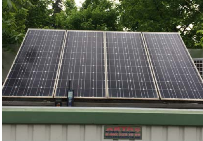
Şekil 2.21. Güneş evindeki panellerin görünümü
