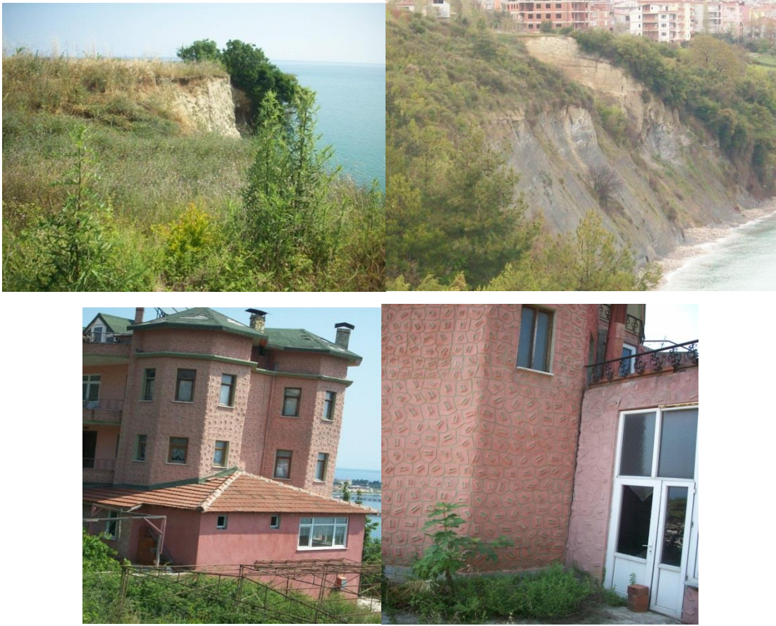
Şekil 44. Gerze İlçesi, Değirmenler mevkiinde heyelan nedeniyle boşaltılan Deniz Feneri Restoran'da meydana gelen hasar ve deniz kıyısından görünümü
