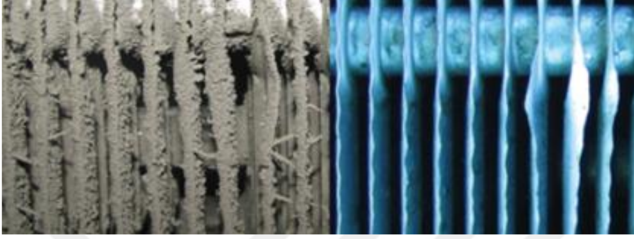
Şekil 6. Soğutma serpantin yüzeylerinde UVC uygulaması öncesi (solda) ve sonrası (sağda) (URL-2, 2019).
