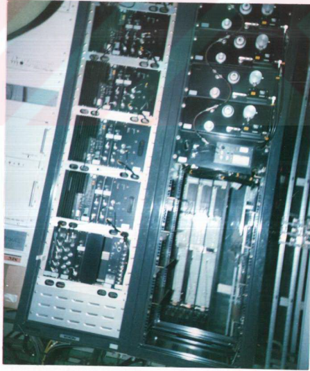
Şekil 39 Bir Yer İstasyonunun iç yapısının görünüşü.
