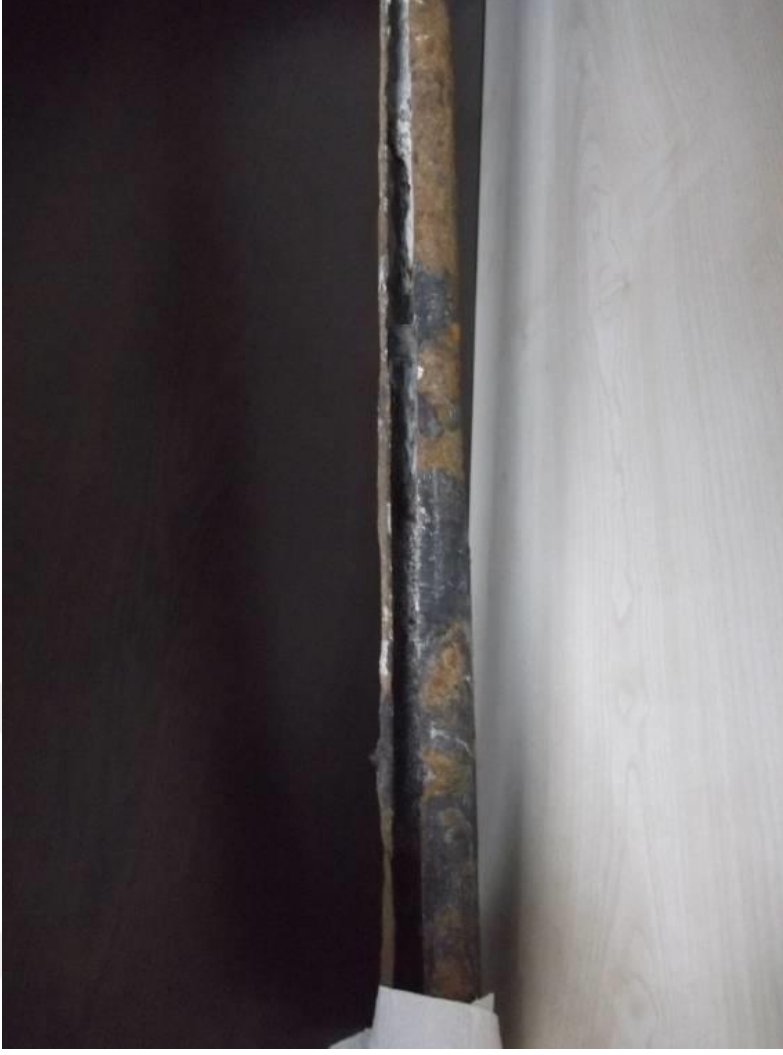
Şekil 3.1. Korozyona uğramış split-set
