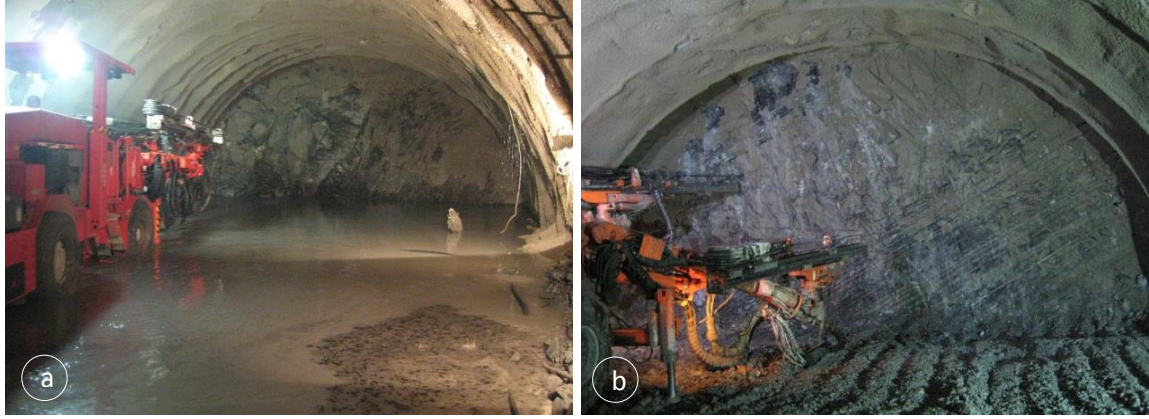
Şekil 2.23. Tünel aynasında su durumunun görünümü, a) Cihala Çayı altındaki aynadan su durumu, b) Tünel aynasında genel bir görünüm (nemli ve ıslak ayna)
