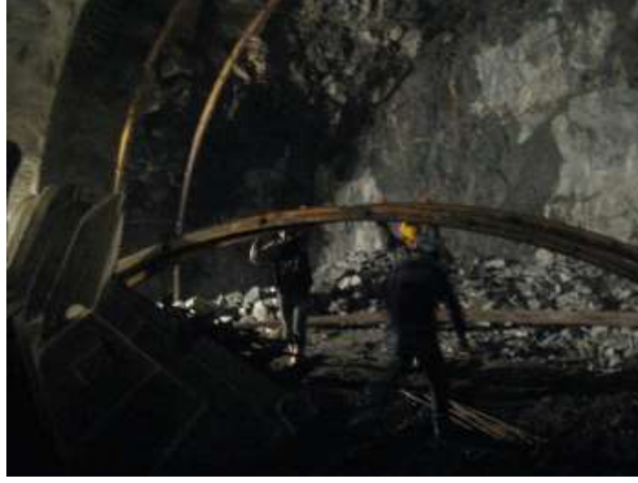
Şekil 1.8. Tünelin göçmemesi için tünel içinde tahkimat amaçlı olarak kullanılan çelik iksalar
