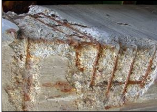
Şekil 1.13. Korozyona uğramış ve aşınmış beton (URL-2, 2014).
