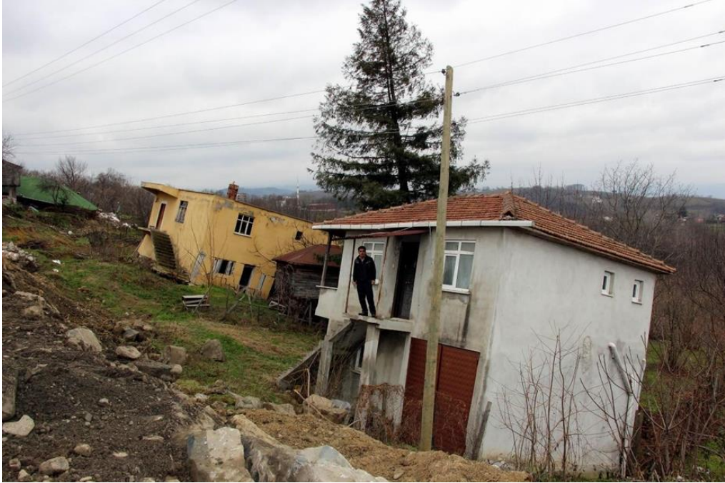
Şekil 14. Heyelan sebebiyle meydana gelen yapı kayması (URL 7).
