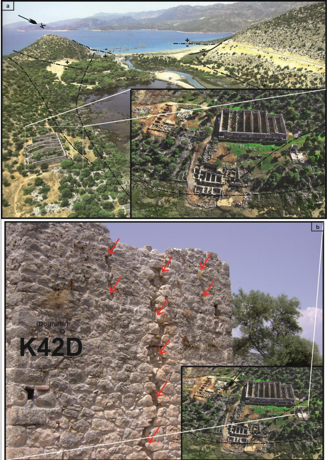
Şekil 41. a; Liman yapılarından olan sinagog binasını etkileyen fayların görünümü (Siyah renkli kesikli çizgiler normal fayları, üzerlerindeki simgeler düşen ve yükselen blokları göstermektedir), b; Güneye bakan sinagog duvarındaki sistematik çatlamlar ve ayrılmalar (Kırmızı renkli oklar duvarın K-G doğrultusunda hasar gördüğünü göstermektedir). Bakış yönü KD'dur.
