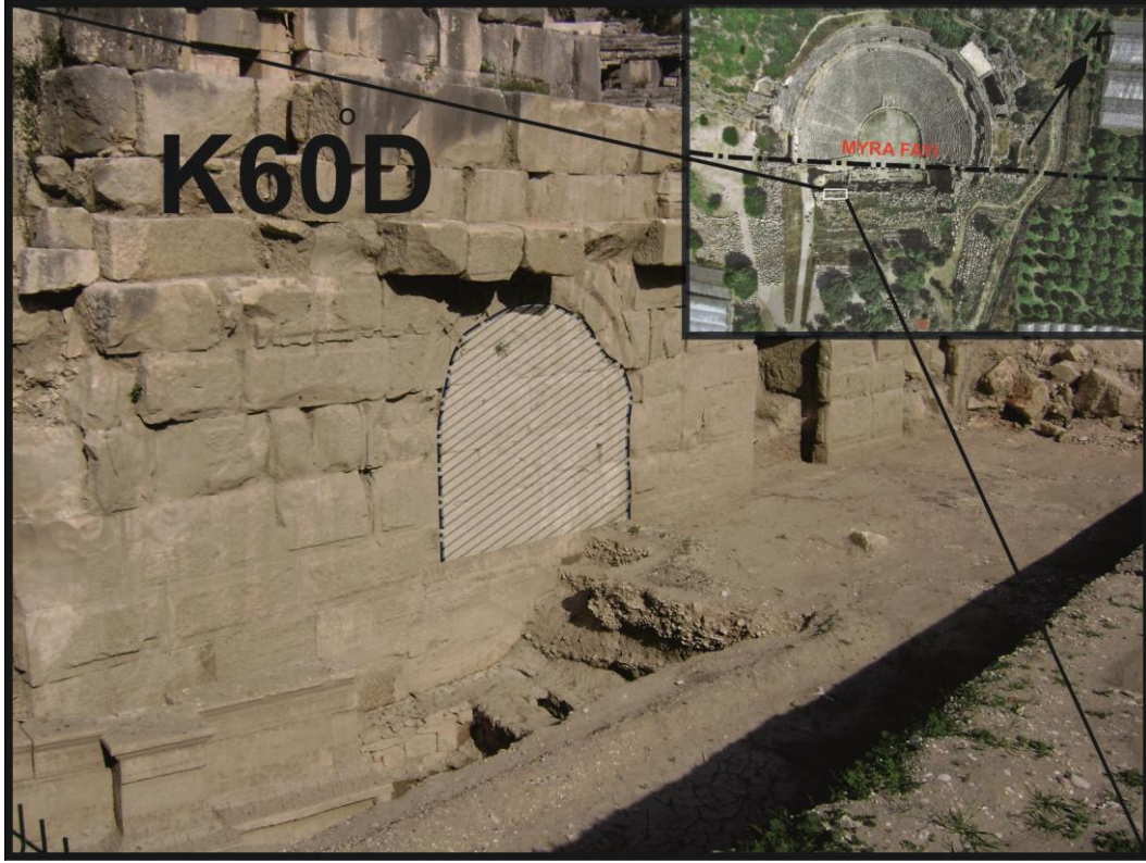
Şekil 36. Tiyatronun sahne binasının sağ alt duvarındaki onarım (Taralı alan M.S. 141 depreminden sonraki onarımı göstermektedir). Bakış yönü KD'dur.
