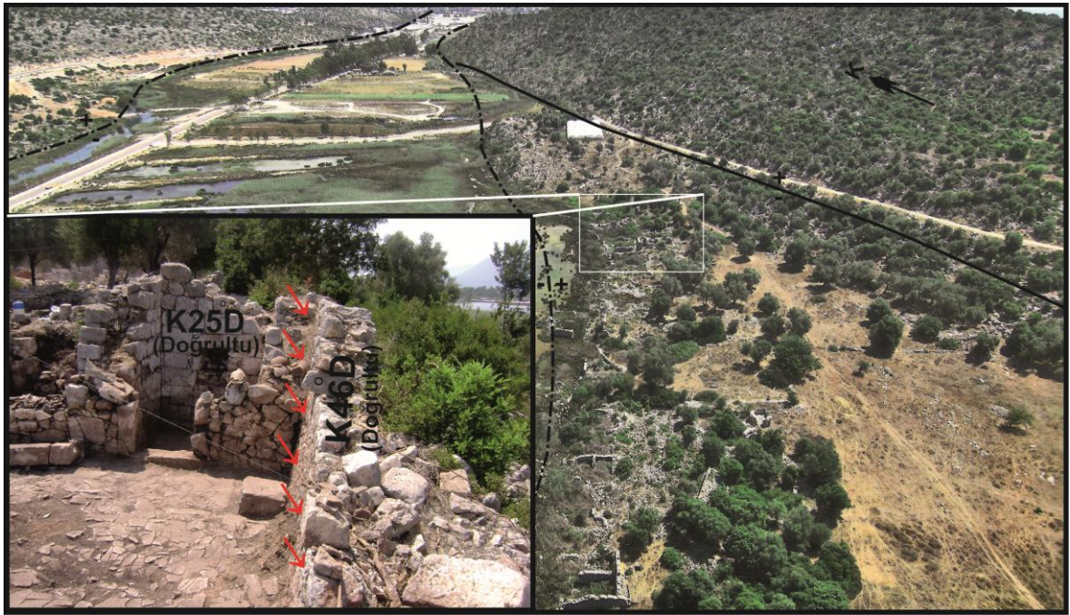
Şekil 38. Andriake limanının yapılarından olan dükkân depolarına ait limana bakan duvarlarında KB yönünde eğimlenme (Kırmızı oklar duvarın eğimlenme yönünü göstermektedir). Bakış yönü GB'dir.
