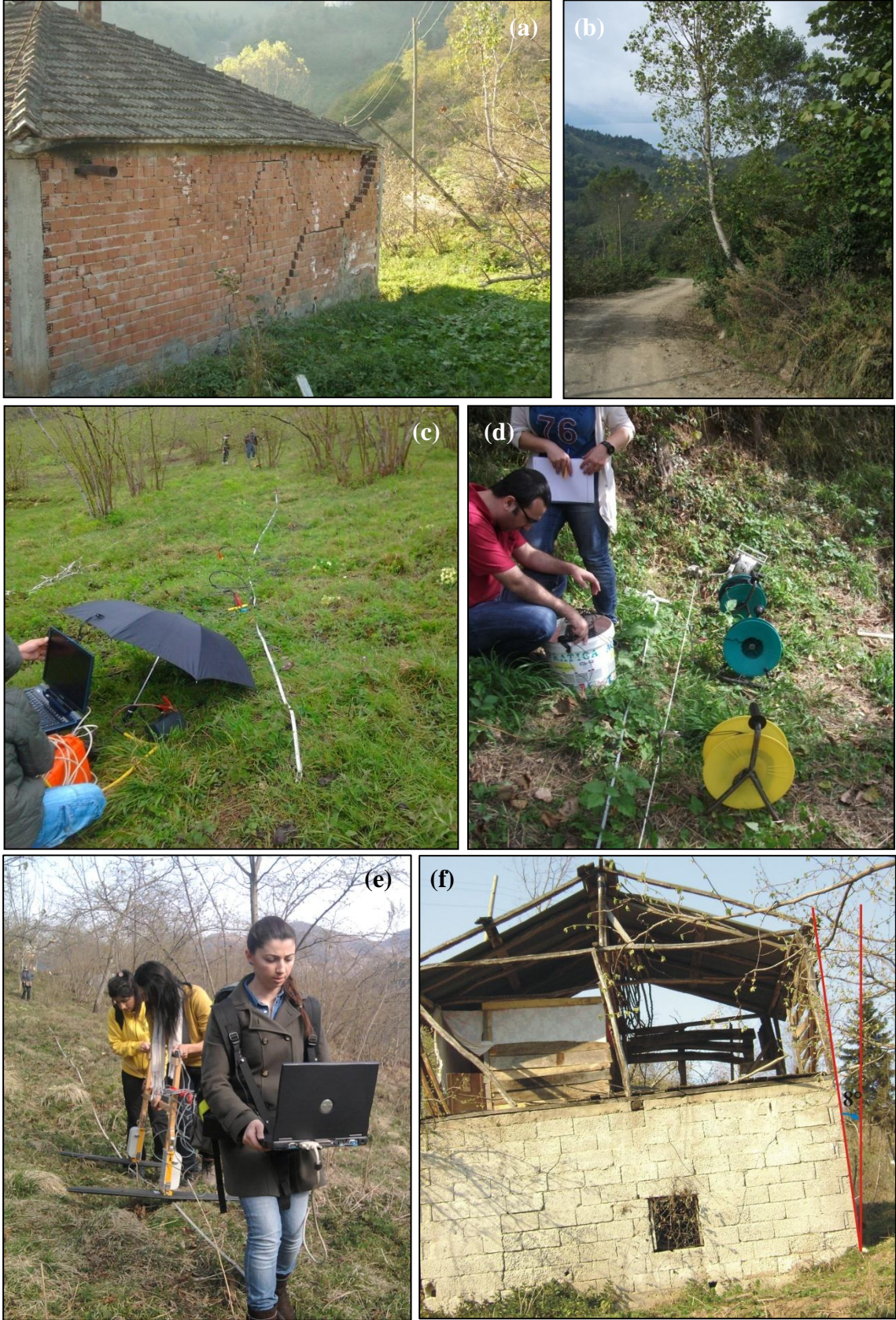
Şekil 3.31. Heyelan sonucu yığma binada gözlenen çatlaklar (a) ve ağaç gövdesinin yataydan sapması (b). Heyelanlı sahada yapılan sismik (c), elektrik-özdirenç (d) ve yer radarı çalışmaları (e). Heyelan bölgesinde hasar gören bir yapı (f).
