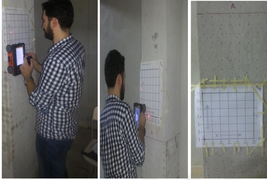
Şekil 79. Yer radarı Model 1 3 boyutlu ölçümünden bir görünüm
