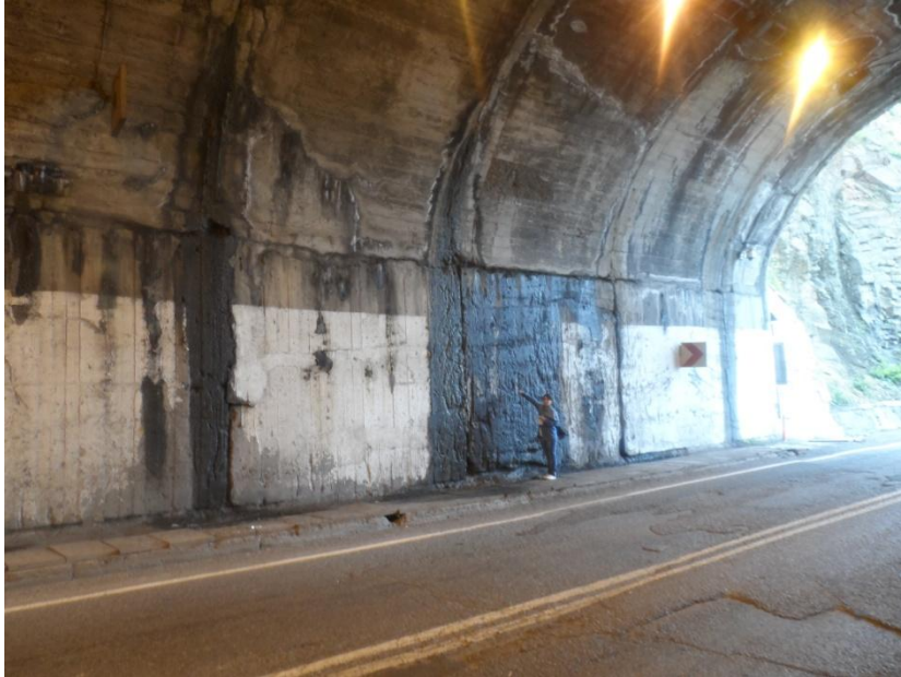
Şekil 3.7. Zigana tüneli Gümüşhane girişinde su sızıntıları ve kırıklı-çatlaklı yapılardan görünüm
