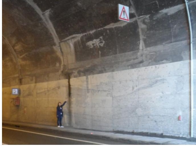
Şekil 3.3. Zigana tüneli Trabzon girişindeki su sızıntısının görünüm
