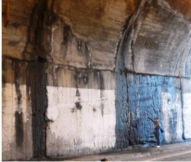
Şekil 2.2. Tünel yan duvarlarından su sızıntısı ve bozulmalardan görünüm
