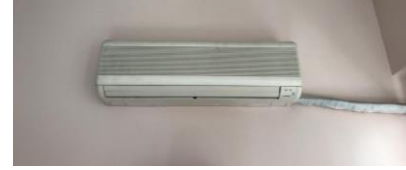
Yapay havalandırma- Klima
