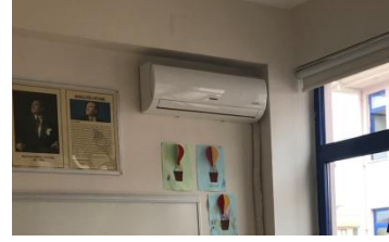
Yapay havalandırma- Klima
