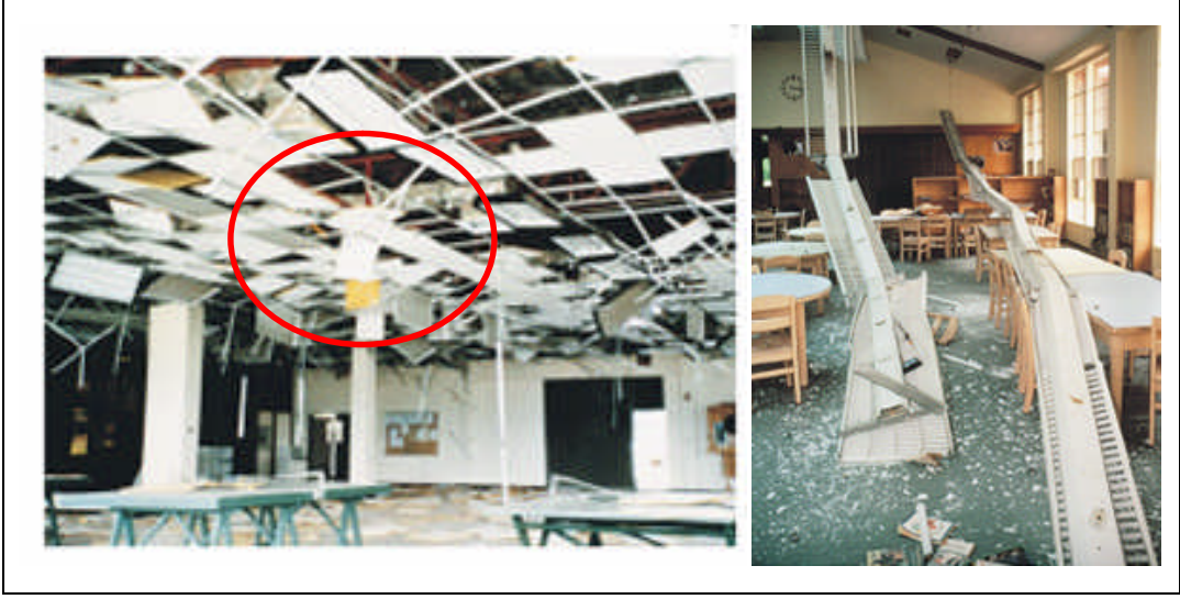
Şekil 52. Deprem sonrası tavan panelleri ve aydınlatma elemanları durumu
