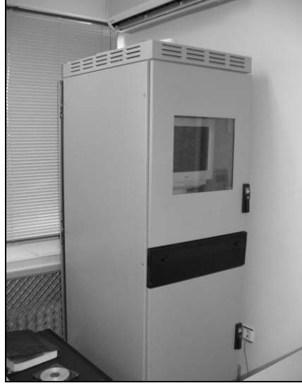
Şekil 2.11. IGS istasyonunun server terminali.
