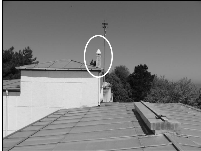
Şekil 2.10. KTÜ Harita Mühendisliği binası çatısına tesis edilmiş TRAB IGS anteni.
