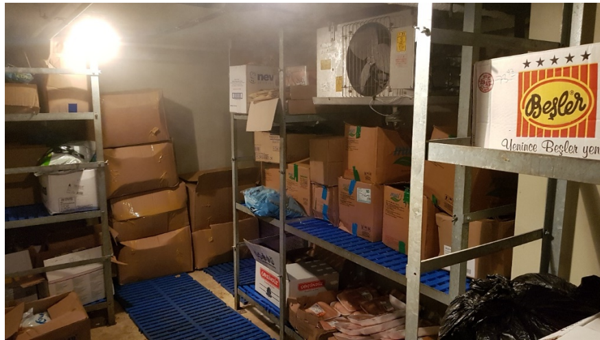
Şekil 2.3. Gemiye ait etlik ve balıklık soğutma odası
