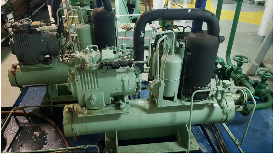
Şekil 2.6. Soğutma sistemi kompresörleri
