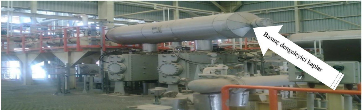
Şekil 30. API 618 Kobelco kompresöründe basınç dengeleyici kaplar (Kobelco, 2006).
