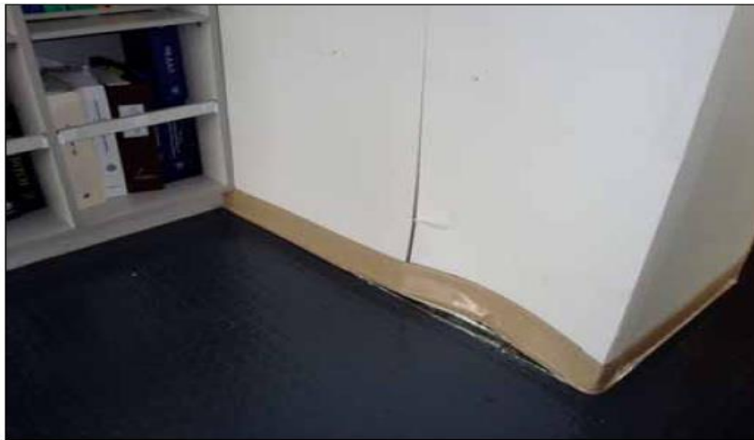
Şekil 3.23. Yaşam mahalli panellerindeki hasar[22]
