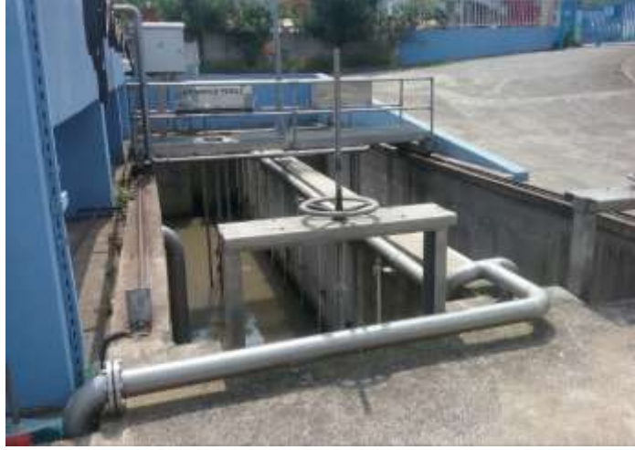
Şekil 12. Havaalanı atıksu ön arıtım tesisi havalandırmalı kum tutucu
