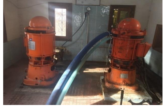
Şekil 17. Su deposu pompaları
