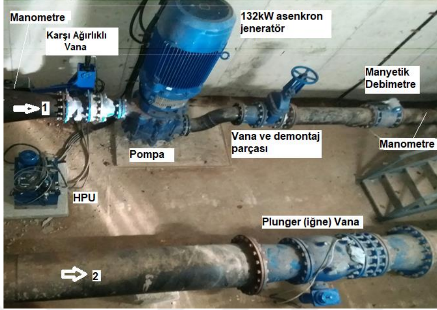
Şekil 32. Karakaya içme suyu grubu mikro HES hidromekanik bağlantılar
