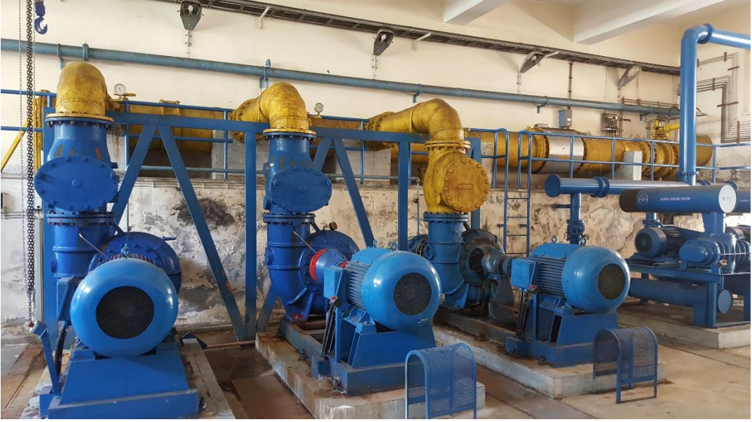
Şekil 43. Esiroğlu İçme Suyu Arıtma Tesisi geri yıkama pompaları
