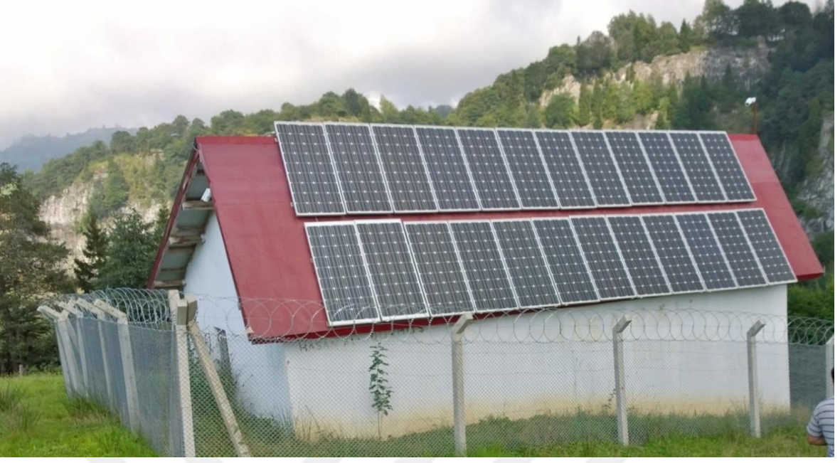
Şekil 45. TİSKİ Tonya Veli Tepesi içme suyu arıtma tesisi
