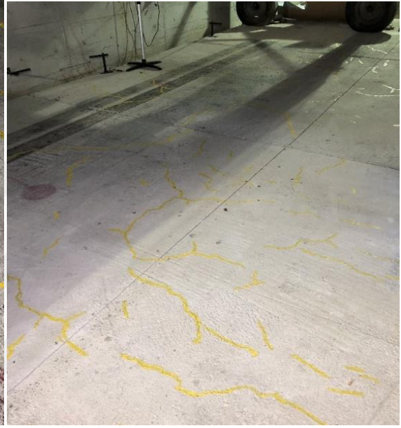
Şekil 2.14. Tekerlek izi ve çatlaklar
