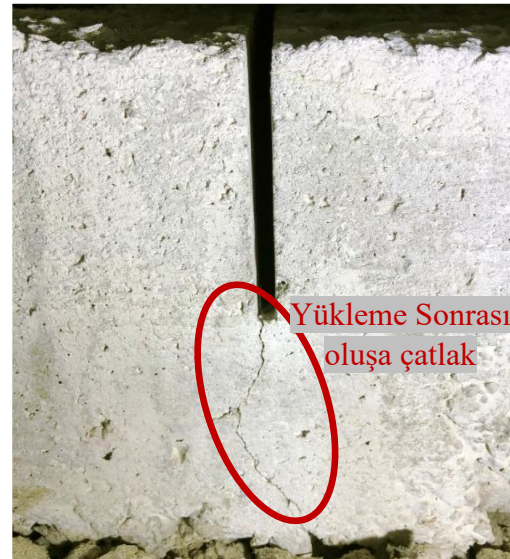
Şekil 3.5. Derz ilerleme çatlakları
