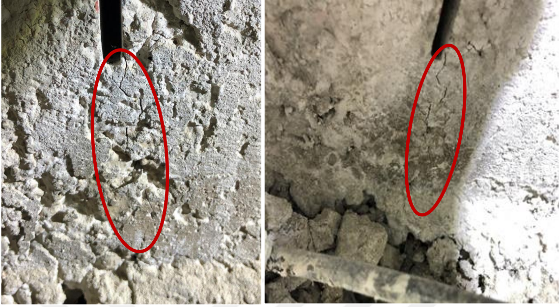
Şekil 3.6. Yüklemeler nedeniyle oluşan diğer derz ilerleme çatlakları
