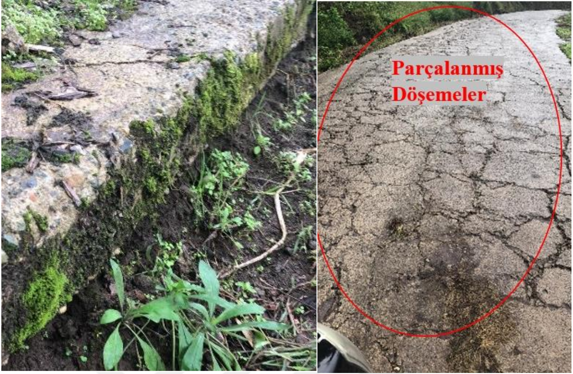
Şekil 1.22. Trabzon Şalpazarı İlçesi, Çarlaklı Mah. beton yolu en az 20 sene önce inşa edilmiş ancak ağır taşıt yükü ve hatalı tasarım nedeniyle oluşan parçalanmış plak
