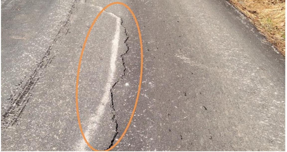
Şekil 1.7. Trabzon İli Çaykara İlçesi Taşören Mahallesi eski beton üzerine yapılan asfalt kaplamada boyuna çatlak oluşumu
