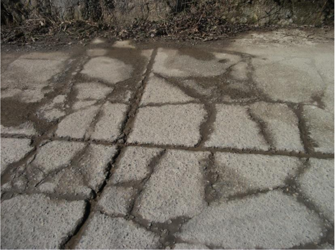
Şekil 1.8. Trabzon Çilekli Mahallesi, ince beton kaplamada parçalanmış plak hasarı
