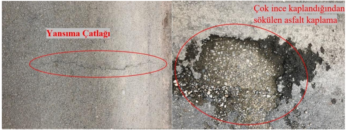
Şekil 1.23. Rize İyidere İlçesi, Denizgören köy yolu, Beton üstü ince asfalt kaplamada yorulma (yansıma) çatlakları ve asfaltın çok ince olduğu yerlerde yük ve çevre etkisi ile kopmalar
