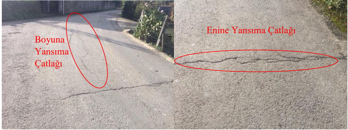
Şekil 1.24 Beşikdüzü İlçesi, Akköse Mah. BÜİAK’da yorulma çatlakları
