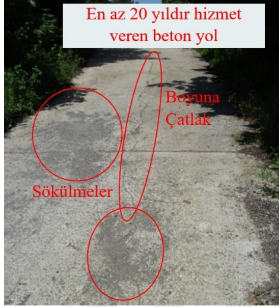
Şekil 1.15. Beşikdüzü, Aksaklı Mah. Yolda boyuna çatlaklar, soyulmalar, talaşlanmalar
