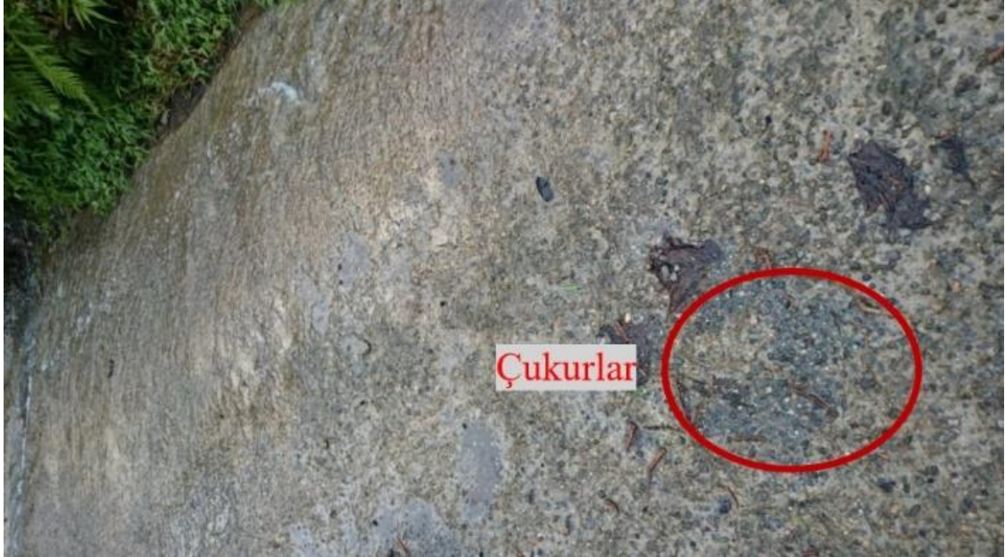
Şekil 1.14. Of İlçesi, yağışlarda drenaj eksikliği ve hidroplaning
