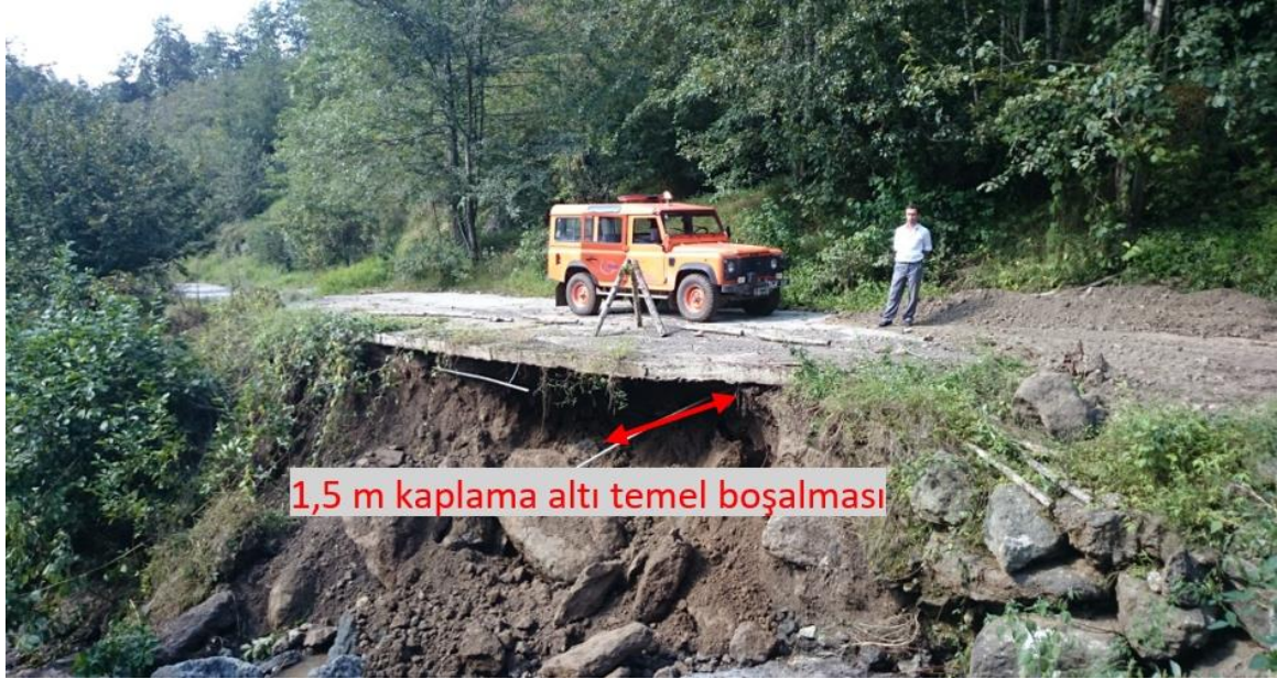
Şekil 1.20. Of ilçesinde yol altında su nedeniyle oluşan akma ve boşalan yol kaplamasının kopması. Temel ve alttemel eksikliği ve suyun doğru tahliye edilmemesi ile oluşan hasar
