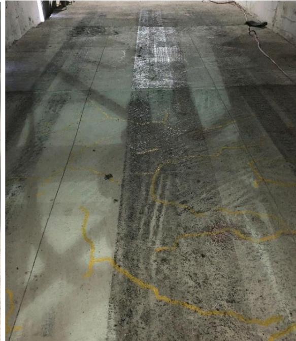
Şekil 2.31. Yüklemelerden sonra beton plaklar
