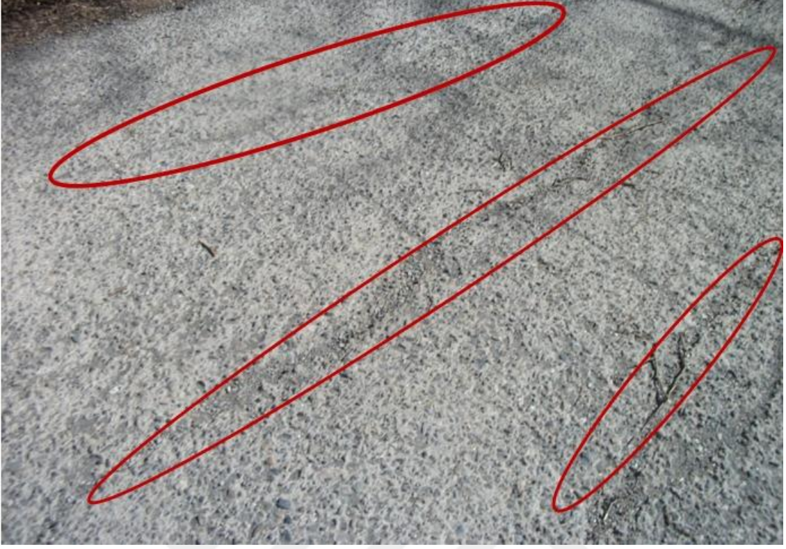
Şekil 1.6. Trabzon Bulak Mah. 30 yıldır kullanılan beton yolda boyuna çatlaklar
