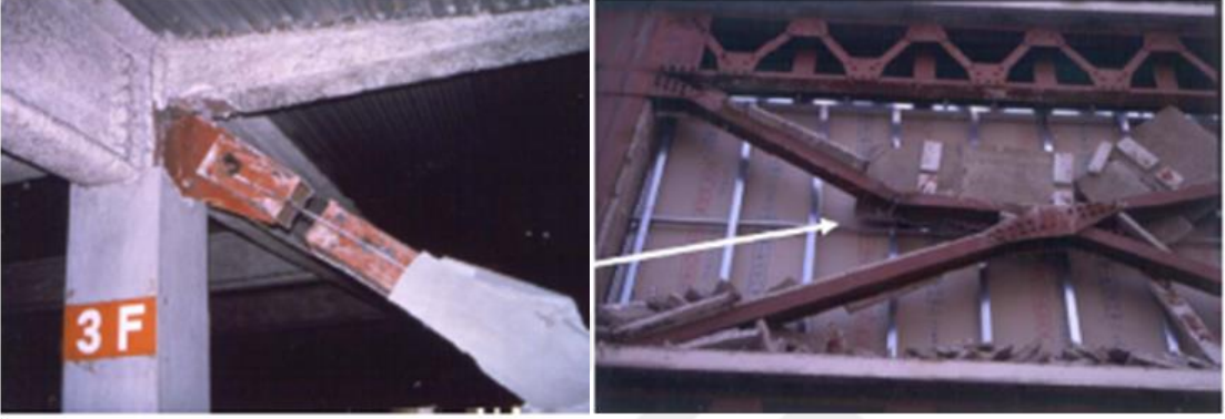
Şekil 1.1. Çelik çaprazlarda burkulma hasarları (Uriz ve Mahin, 2008).
