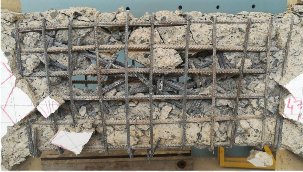
Şekil 3.8. Büyük yerdeğiştirme altındaki sargılı diyagonal donatılı bağ kirişinde oluşan hasar
