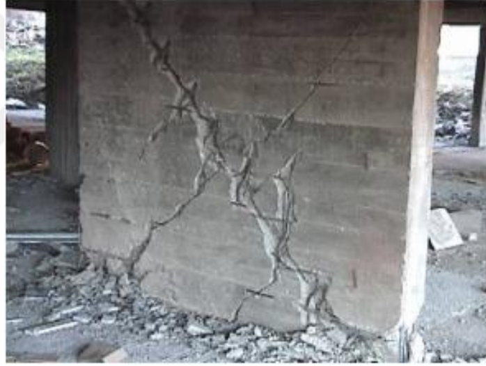
Şekil 1.4. 1999 Düzce depreminde kesme kırılması meydana gelen bir perde duvar (Ireland vd., 2006)
