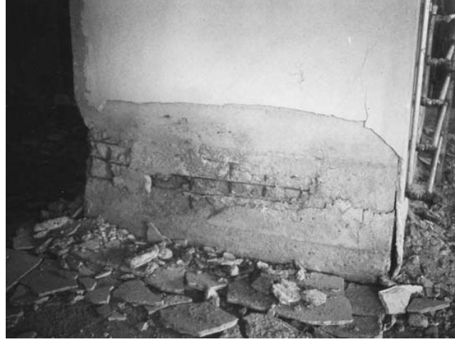
Şekil 1.3. 2002 Çay depreminde eğilme göçmesine maruz bir perde duvar (Eren, 2010)
