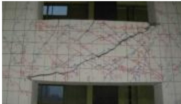
Şekil 1.26. Diyagonal yarılma ile göçmeye maruz bağ kirişi (Ahn vd., 2011)
