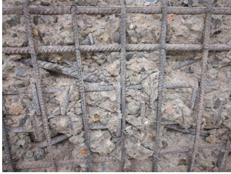
Şekil 3.13. Nihai hasar sonrası diyagonal donatıların burkulması
