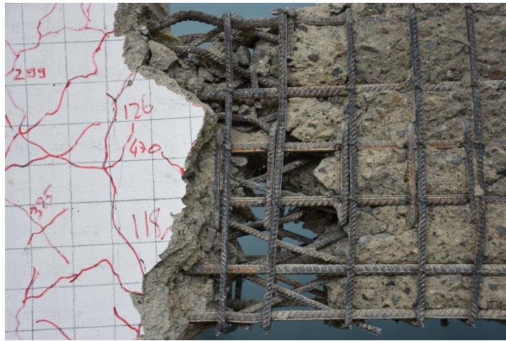
řekil 3.23. Nihai hasar sonrası donatılarda burkulma
