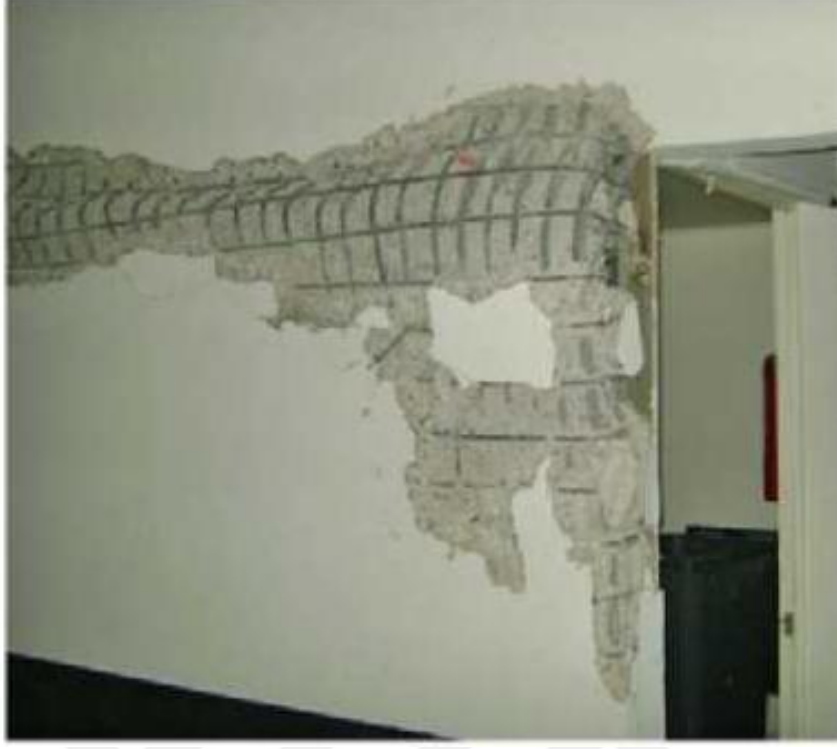
Şekil 1.6. 2010 Şili depreminde yanal burkulmaya maruz perde duvar (Wallace vd., 2012)
