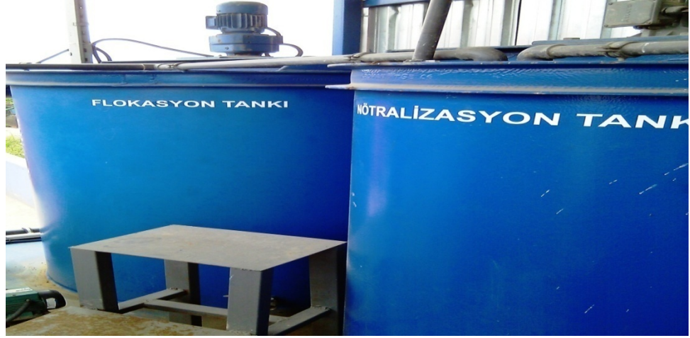
Şekil 20. Atıksu arıtma tesisindeki nötralizasyon ve flokülasyon tankları
