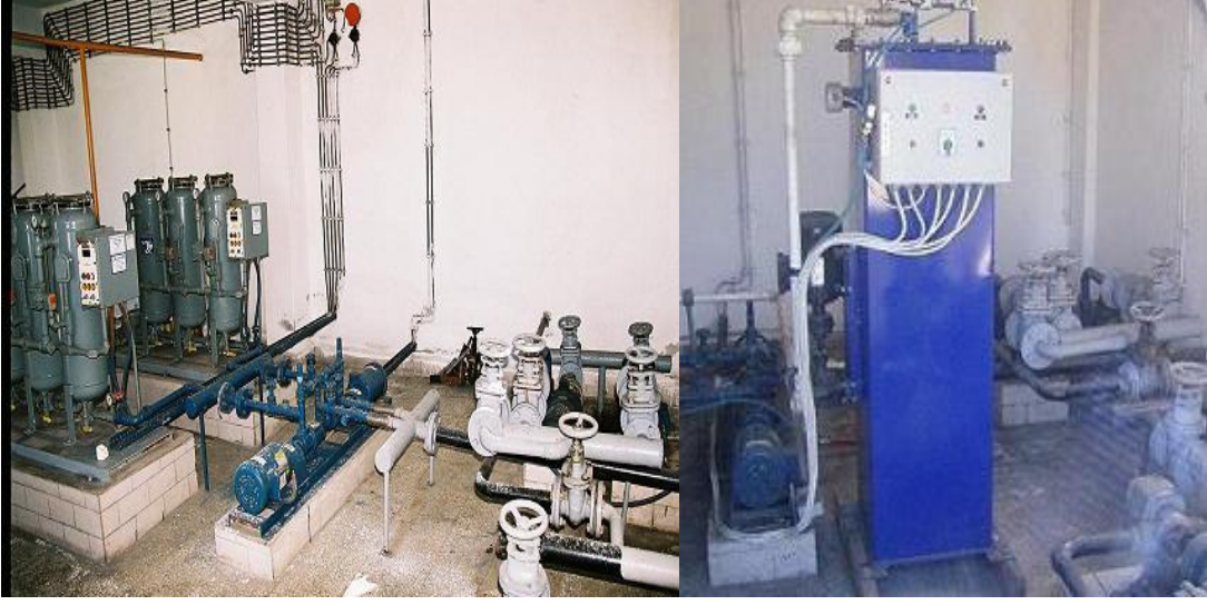
Şekil 7. Sintine suyu arıtma tesisi iç bölümünün görünüşü
