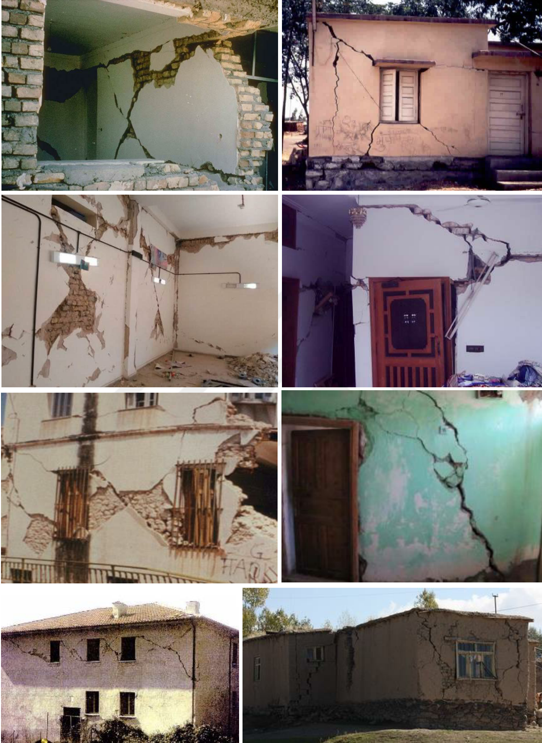
Şekil 1.23. Deprem sonrası yığma yapı duvarlarındaki düzlem içi hasarlar [22, 23, 24]
