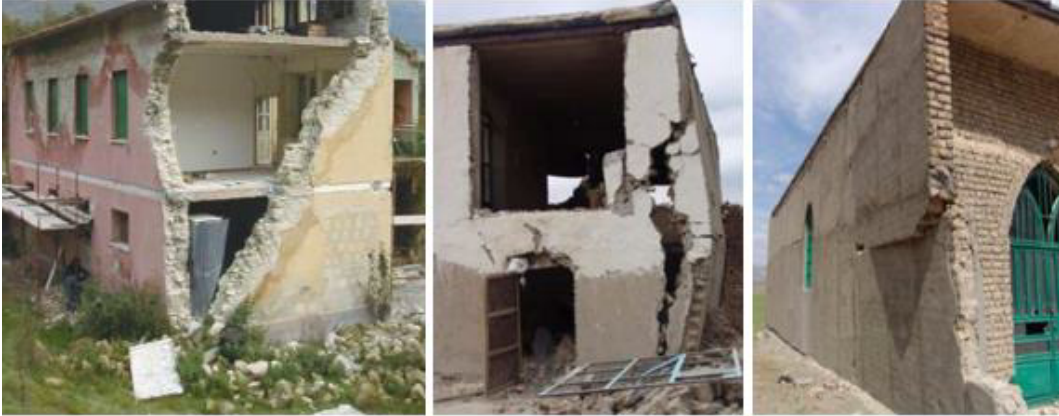
Şekil 1.22. Deprem sonrası yığma yapı duvarlarındaki düzlem dışı hasarlar [22]
