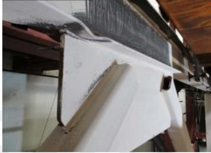
Şekil 2. Hasarlı bir bağ kirişinden görünüm (Demir, 2018)
