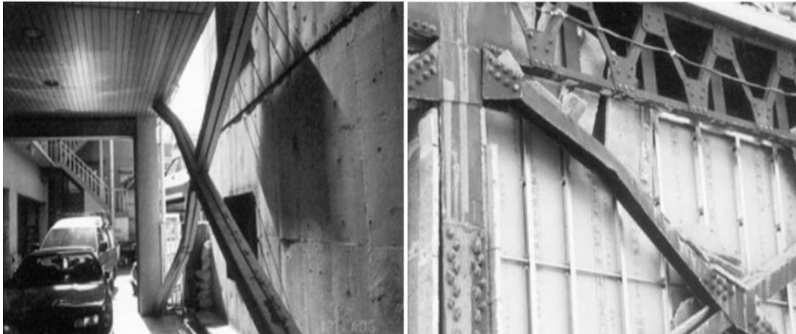
Şekil 3. Merkezi çelik çaprazlarda burkulma hasarları (Aguero ve diğ. 2006)
