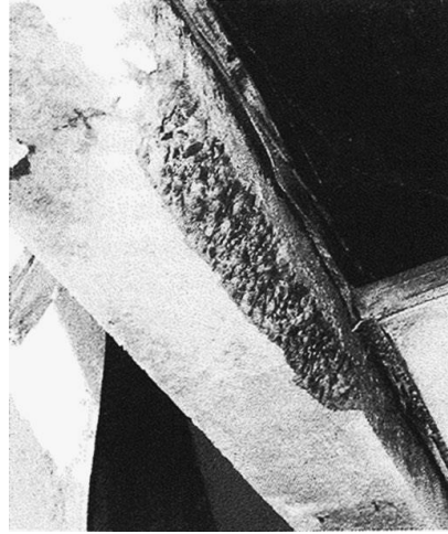
Şekil 1.18. Betonda yüksek sıcaklıktan dolayı oluşan köşe dökülme kabuk atması (H. Buchanan ve K. Abu, 2017)
