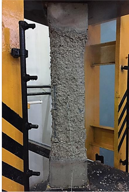
Şekil 3.48. Betonda ısıl şok etkisinde oluşan yüzeysel soyulma
