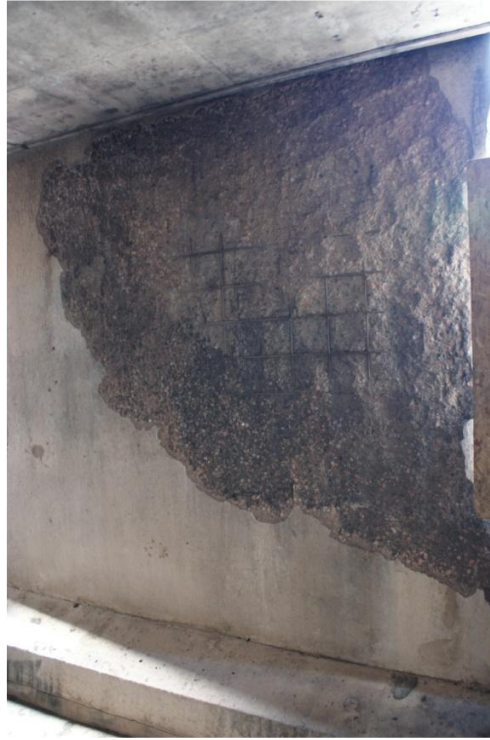
Şekil 1.15. Betonda yüksek sıcaklıktan dolayı oluşan agregat kabuk atması (R. Jansson, 2013)
