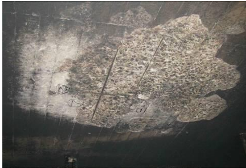
Şekil 1.13. Betonda yüksek sıcaklıktan dolayı oluşan kabuk atma olayı (R. Jansson, 2013)
