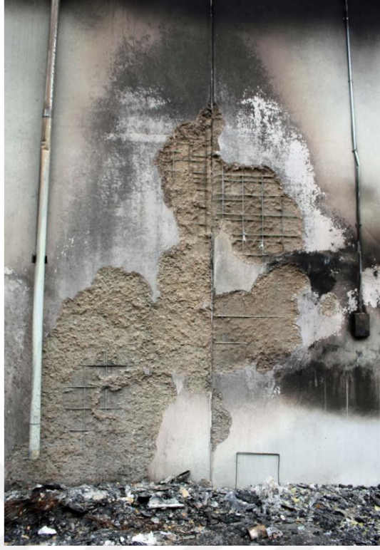
Şekil 1.16. Betonda yüksek sıcaklıktan dolayı oluşan yüzeysel kabuk atma (R. Jansson, 2013)
