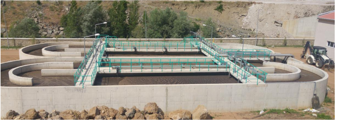
Şekil 2.14. Gümüşhane Atık Su Arıtma Tesisi'nin biyolojik arıtma ünitesi, oksidasyon hendeği
