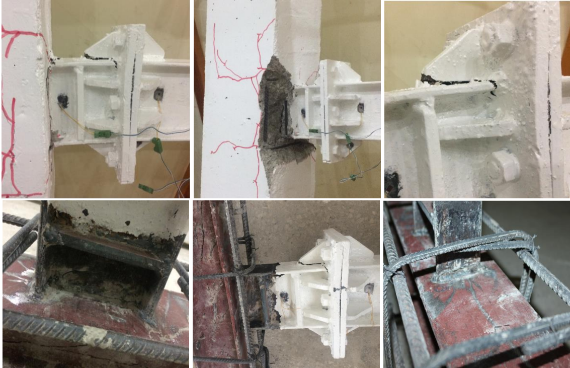
Şekil 3.33. Deney sonunda KKB-H deney elemanında oluşan hasar durumları
