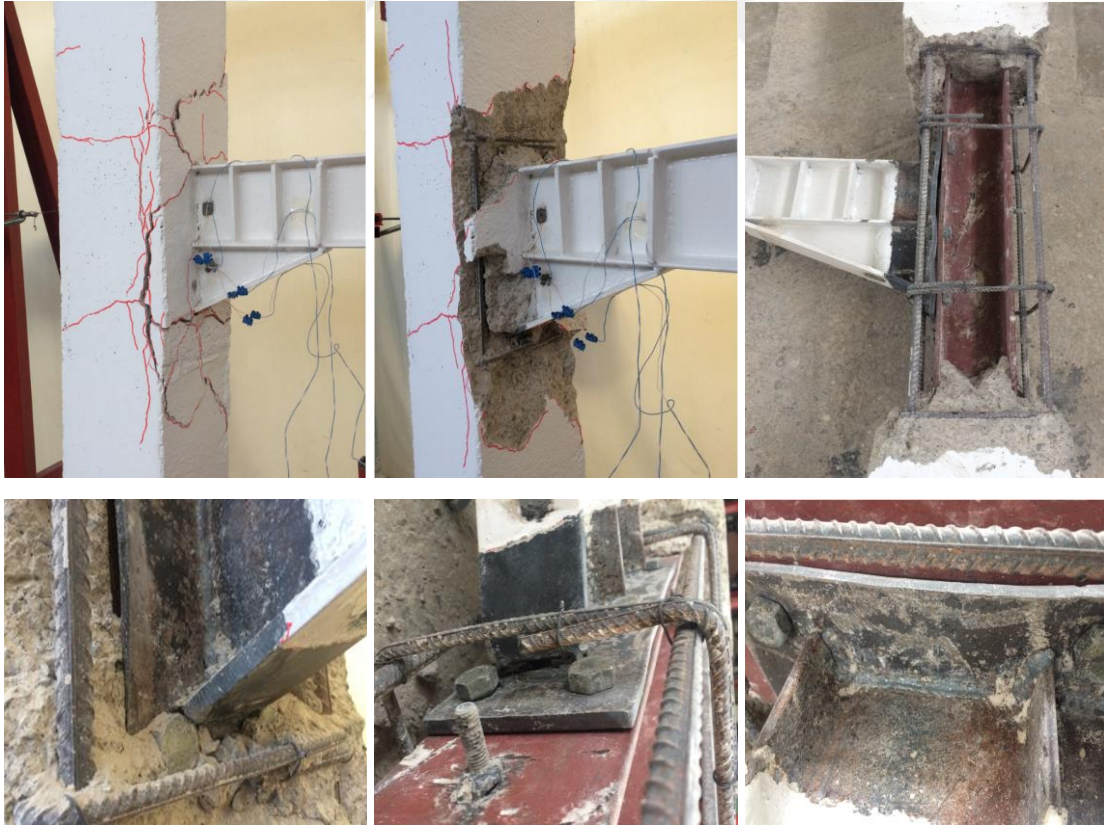
Şekil 3.17. Deney sonunda KKB-D deney elemanında oluşan hasar durumları
