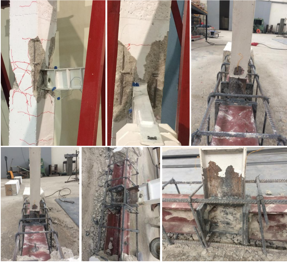
Şekil 3.13. Deney sonunda KKB-C deney elemanında oluşan hasar durumları
