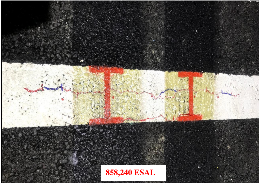
Şekil 3.52. Doğu şeridi (RP) 2. derzde yansımaya çatlağı son hali
