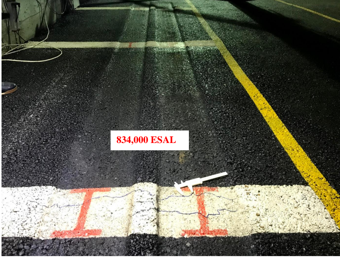
Şekil 3.44. Batı şeridi (RP) 2. derzde yansımaya çatlağı son hali
