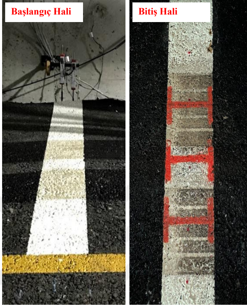
Şekil 3.49. Doğu şeridi (RJF) 1. derzde yansımaya çatlağı ilerlemesi
