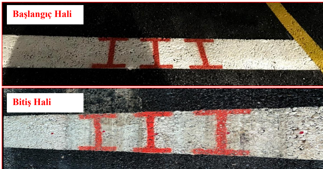
Şekil 3.41. Batı şeridi (RJF) 1. derzde yansıma çatlakları ilerlemesi
