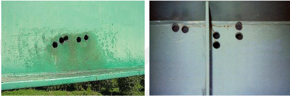
Şekil 1.63. Çatlak ucunun kaçırılması sonucunda kiriş gövdesinde zamanla açılan ardışık çatlak durdurma delikleri (FHWA, 2013; Connor ve Lloyd, 2017).
