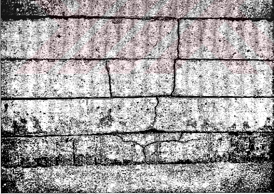
Şekil 2.37. Yüksek başarımlı ve geleneksel beton ve betonarme kirişlerin kırılma yükü altında momentin sabit olduğu bölgedeki çatlama durumlarına ilişkin bir fotoğraf
