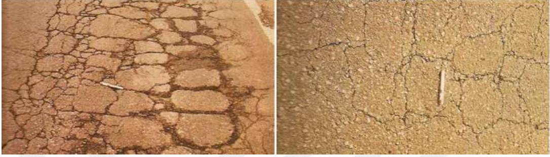
Şekil 23. Yüksek ve orta şiddetli yorulma çatlakları
