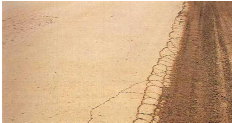
Şekil 24. Kenar çatlak oluşumu
