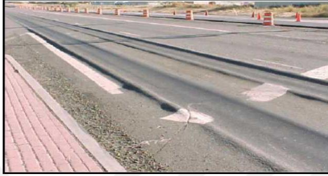
Şekil 19. Tekerlek izi oluşumu
