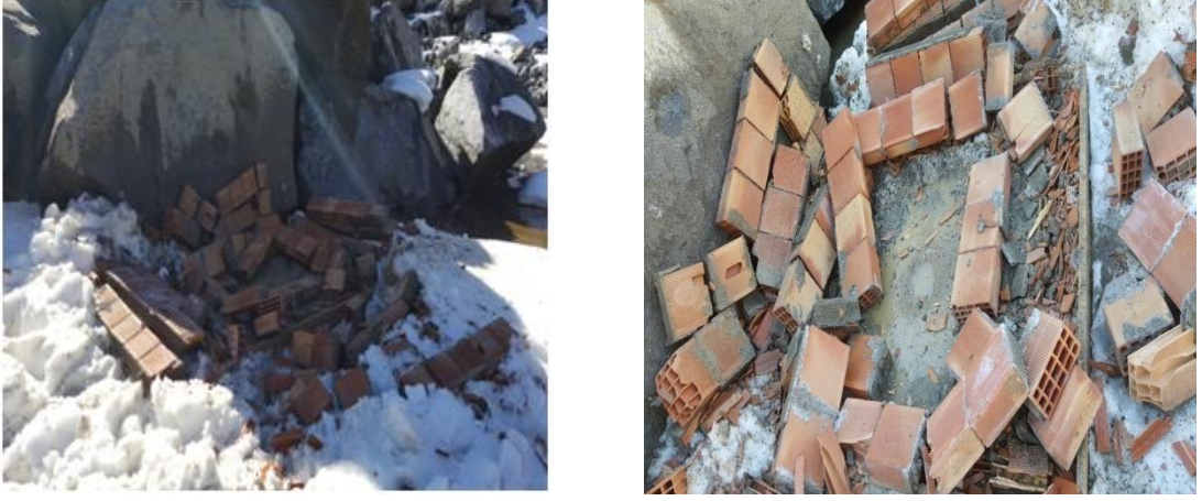
Şekil 2.3. 290 gr TNT ile yapılan deney sonrası mesnetlerinden ayrılarak tamamen yıkılan tuğla duvar
