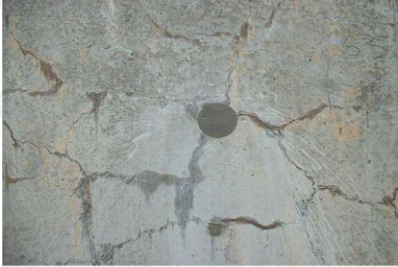
Şekil 8. GEO ve ASR sonucu harita şeklinde çatlamanın olduğu betonarme köprü kanat duvarının görüntüsü [28].
