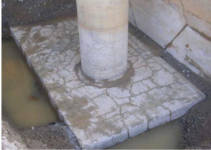
Şekil 11. Köprü kazık başlıklarda harita şeklinde çatlaklar
