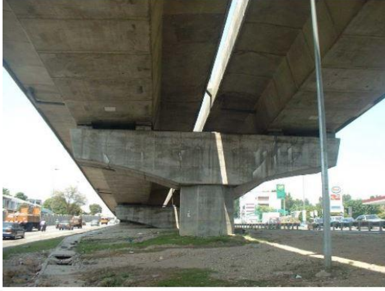
Şekil 7. Bir otoyol viyadük ayağında GEO nedeniyle oluşan çatlaklar [27].
