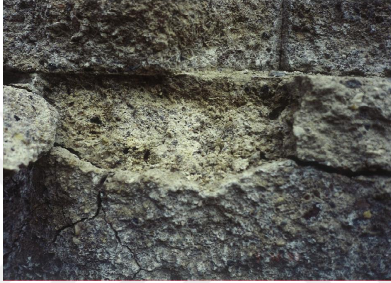
Şekil 19. Tomasit oluşumu nedeniyle öndöküm beton istinat duvarında meydana gelen hasar [45].
