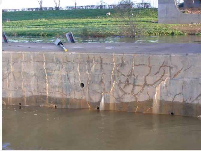
Şekil 10. Köprü taban betonunda GEO kaynaklı çatlaklar (Bourgogne Köprüsü)
