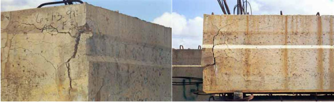
Şekil 3. Öngerilmeli köprü kirişlerinde meydana gelen GEO kaynaklı hasar
