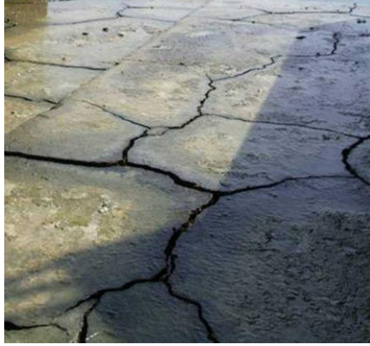
Şekil 9. GEO kaynaklı rıhtım duvarında oluşan çatlama [26].
