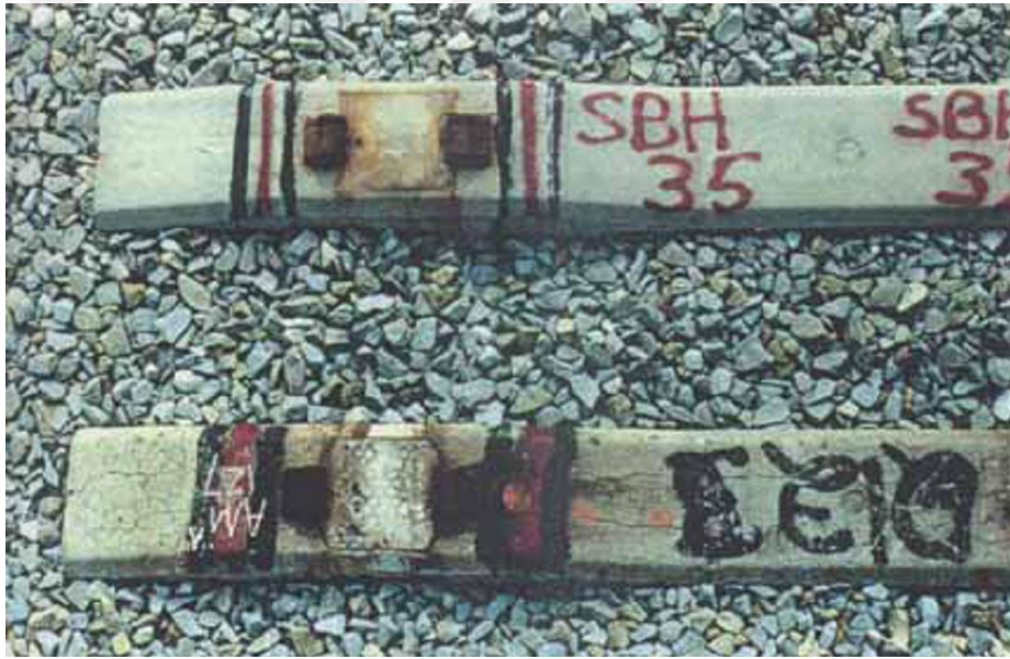
Şekil 1. GEO kaynaklı hasar görmüş travers (altta)
