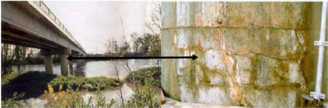
Şekil 5. Köprü başlığında GEO kaynaklı meydana gelen hasar [22].
