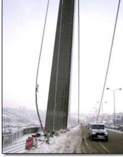
Şekil 2.1. Askı-tabliye bağlantısındaki oluşan hasar [44]
