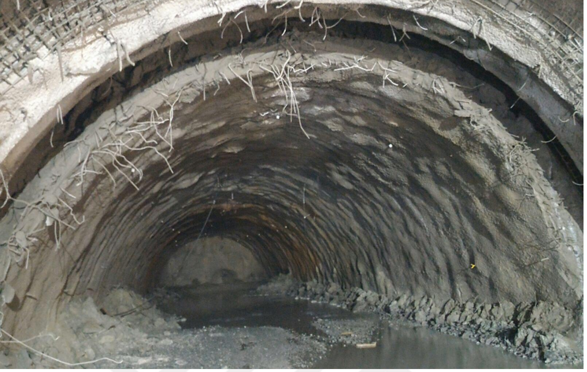
Ek 43. Tünel Göçük Bölgesi
