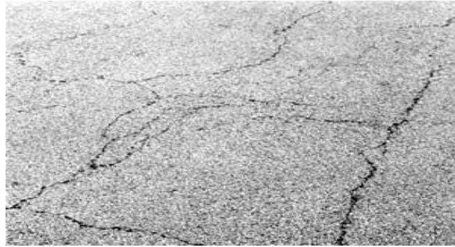
Şekil 15. Blok (Büzülme) çatlakları (URL-5, 2019)
