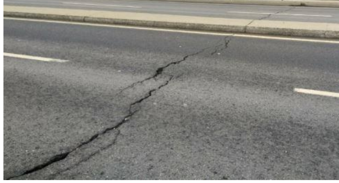
Şekil 14. Enine çatlak (URL-8, 2019)
