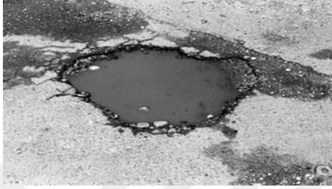
Şekil 9. Kaplama bölgesel çökme (URL-5, 2019)
