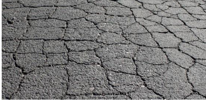
Şekil 12. Timsah sırtı çatlaklar (URL-7, 2019)
