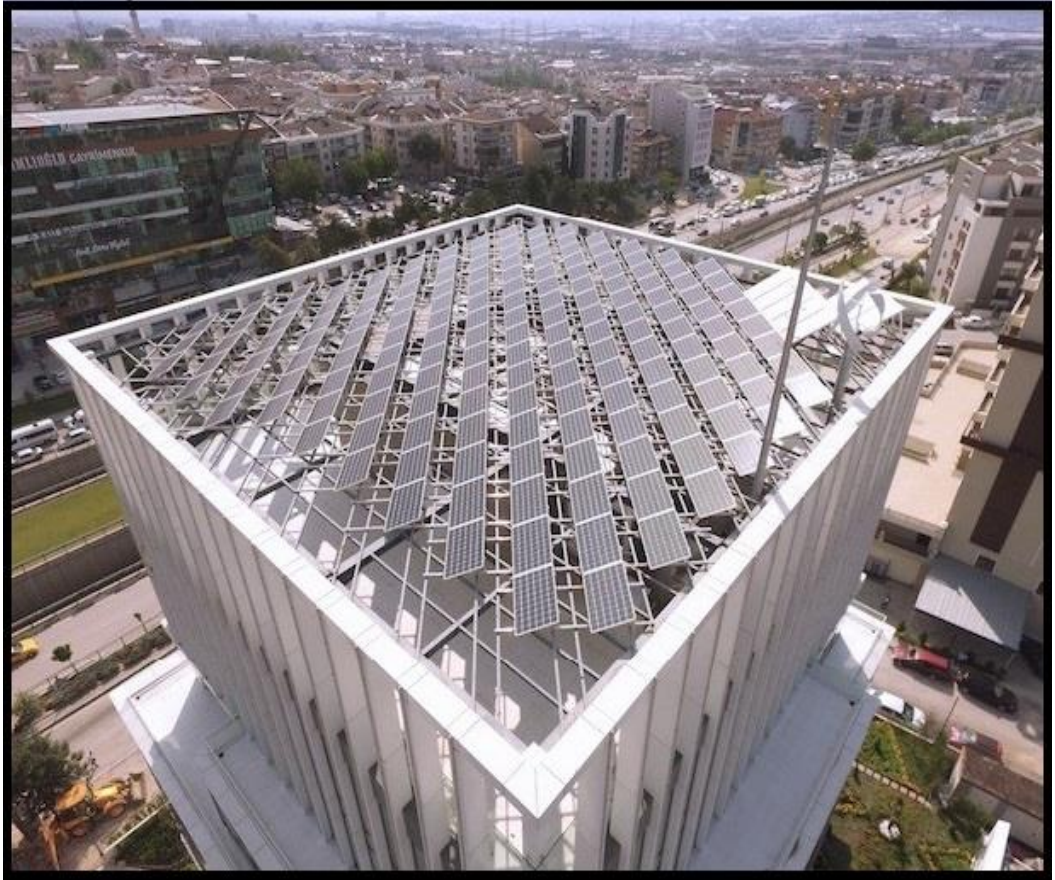
Şekil 1.20. Ewe & Bursagaz merkez ofisi bina monte pv panel uygulaması (URL-8, 2019)
