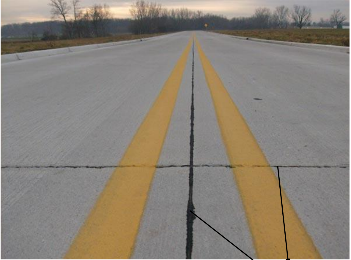
Şekil 4. Beton kaplamada derzler
