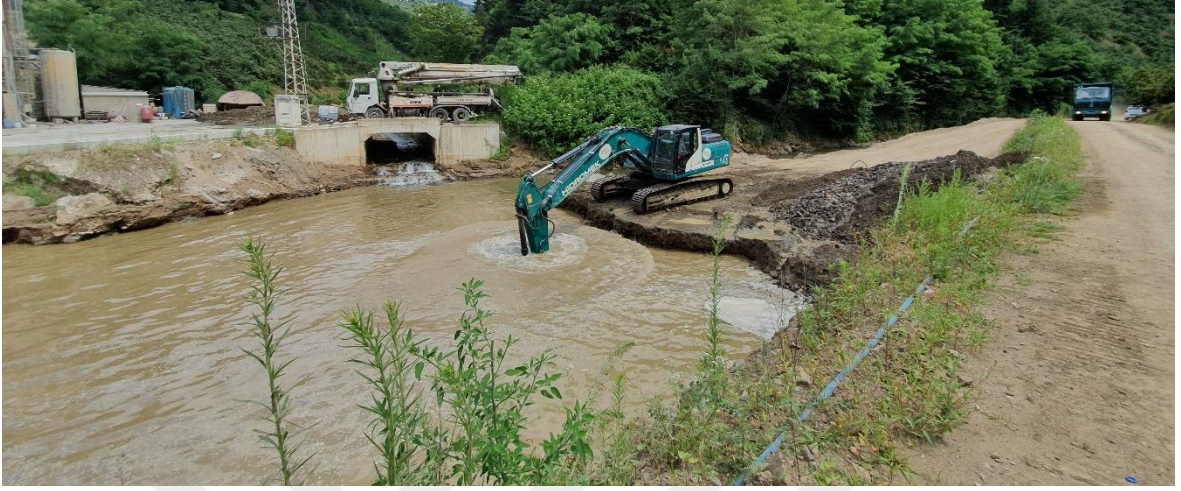
Şekil 3. Sera Deresi (Trabzon) ana kol üzerinde mabadaki ikinci tersip bendi rezervuarının temizleme çalışması (28.07.2019)
