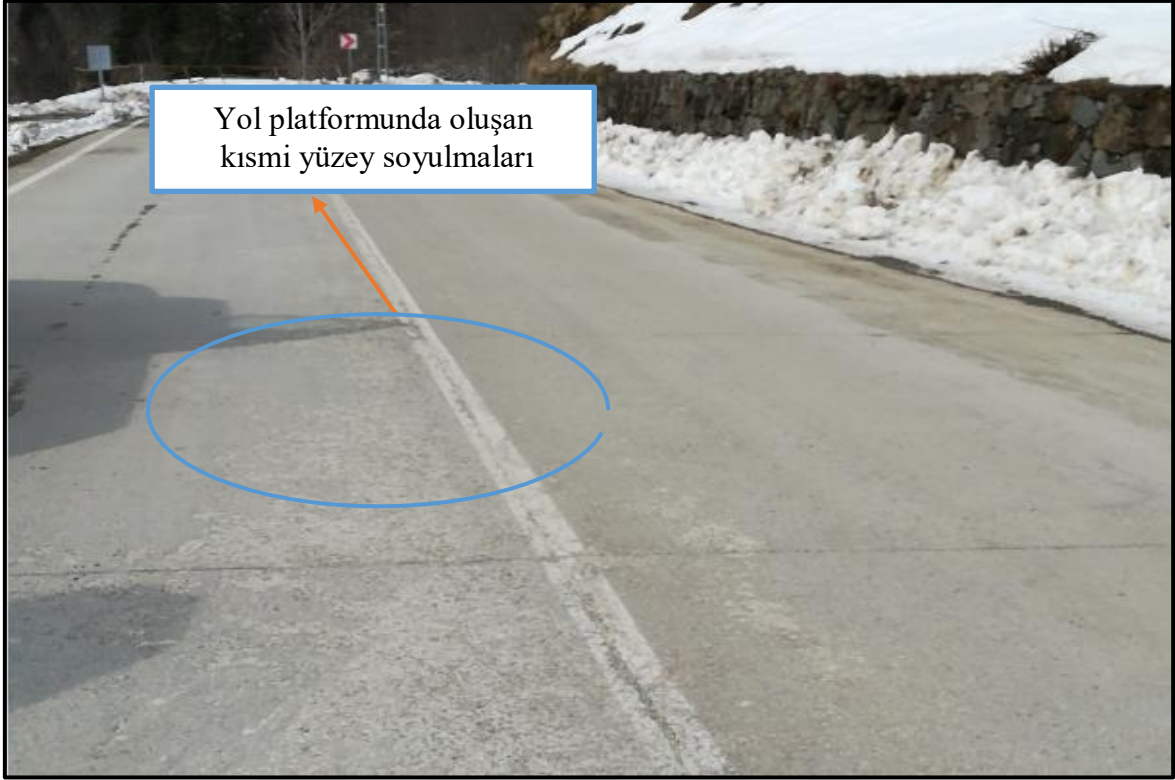
Şekil 2.12. Çayırçi mevkinde bulunan beton yolda kısmi yer yer soyulmalar
