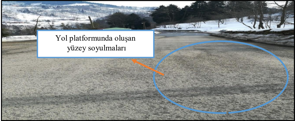
Şekil 2.4. Tonya Merkez Kaleönü Mah. - Çayırıcı Köprü arası asfalt kaplamasında yol boyunca yüzeysel soyulmalar gözlemlenmektedir
