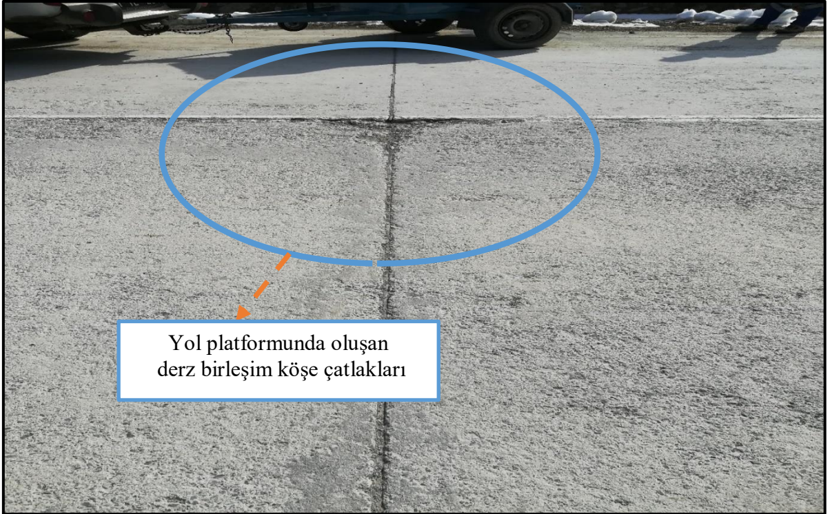
Şekil 2.11. Çayırıcı mevkinde bulunan beton yolda derz birleşim yerinde köşe çatlakları
