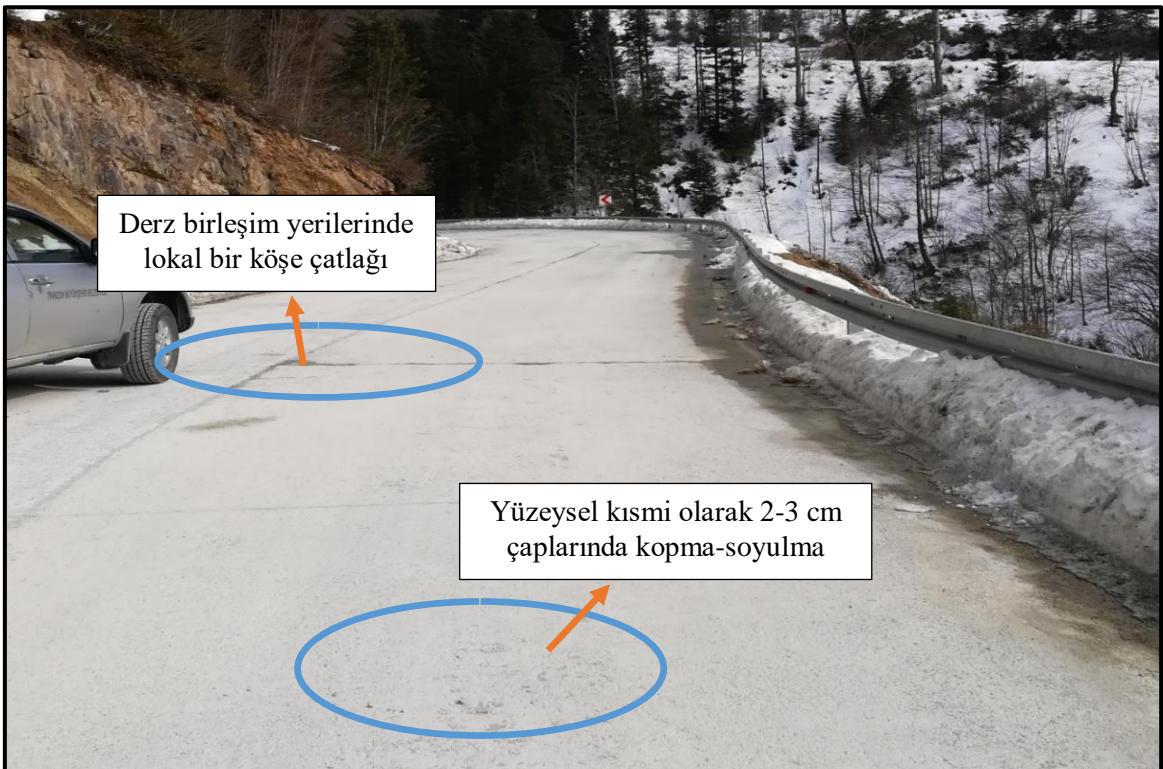
Şekil 2.27. Kalınçam-Erikbeli arası beton yolda kısmi soyulma ve derz birleşim çatlakları
