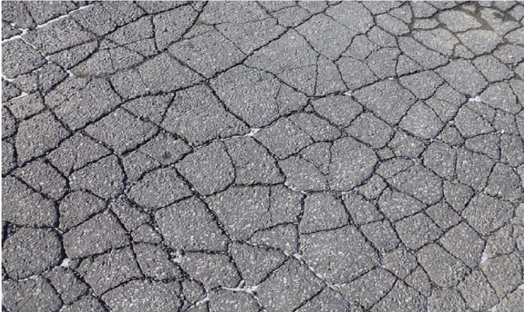
Şekil 6. Yorulma çatlakları (Ahmad ve Khawaja, 2018).
