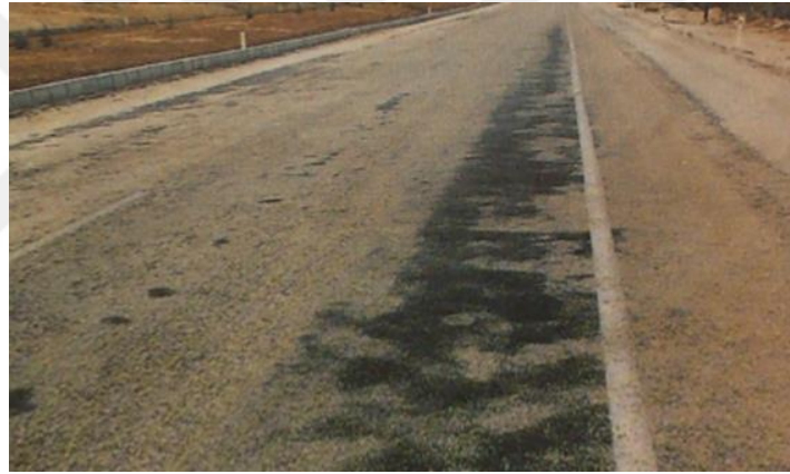
Şekil 9. Asfalt kaplamanın kusması
