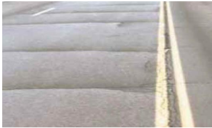
Şekil 7. Enine çatlaklar (Hanlı, 2009)
