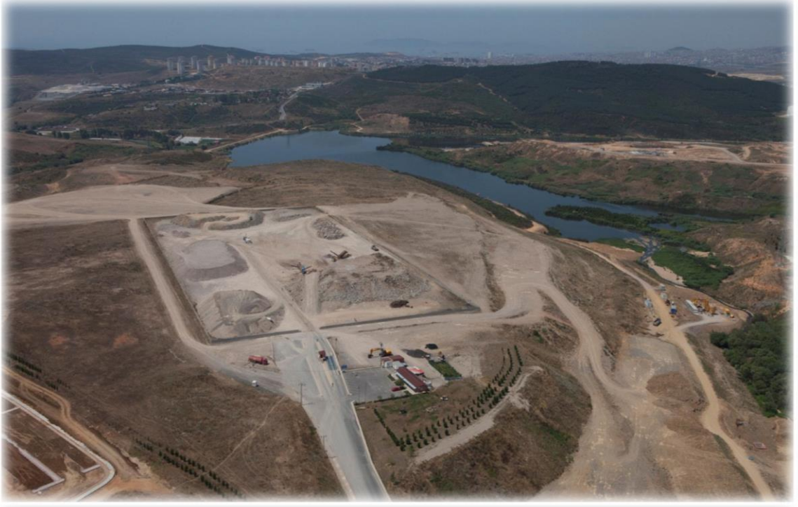
Şekil 4. 2008-2012 yıllarında faaliyet gösteren İSTAÇ'ın Tuzla-Aydınlı'daki geri kazanım ve depolama tesisi (45.000 m 2 ) [47].
