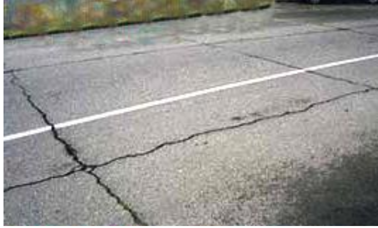
Şekil 20. Yansıma Çatlağı (Yılmaz, 2016)
