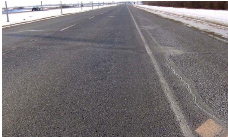
Şekil 16. Kenar çatlakları (Kirizgil, 2013).
