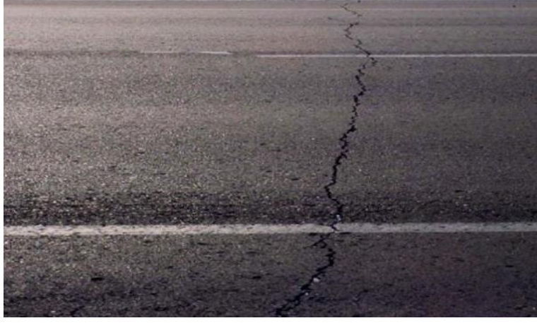
Şekil 17. Enine çatlaklar (Kirizgil, 2013)
