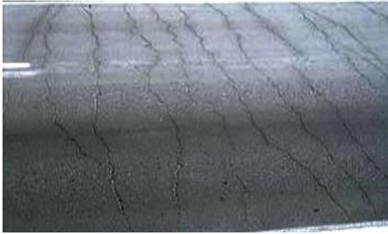
Şekil 19. Düşük ısı çatlakları (Yılmaz, 2016)
