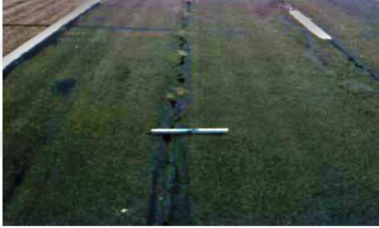
Şekil 18. Boyuna çatlaklar (Kirizgil, 2013)
