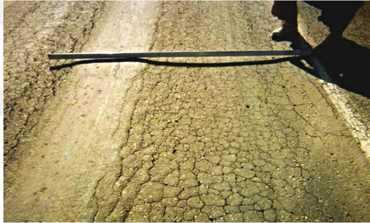
Şekil 15. Timsah sırtı çatlaklar (Kirizgil, 2013).
