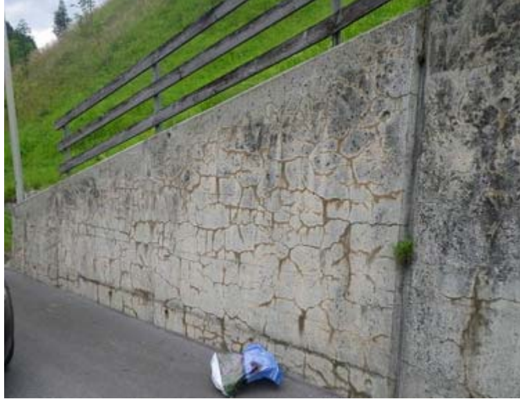
Şekil 1.33. Alkali-Agrega Reaksiyonu sonucu oluşan çatlak yapısı[64]
