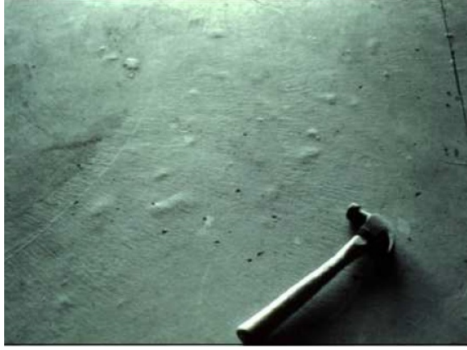
Şekil 1.37. Yüzeyde hava kabarcığı oluşumu
