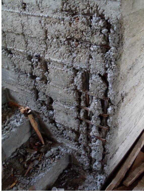
Şekil 1.28. Bir yapıda oluşan ayrışma
