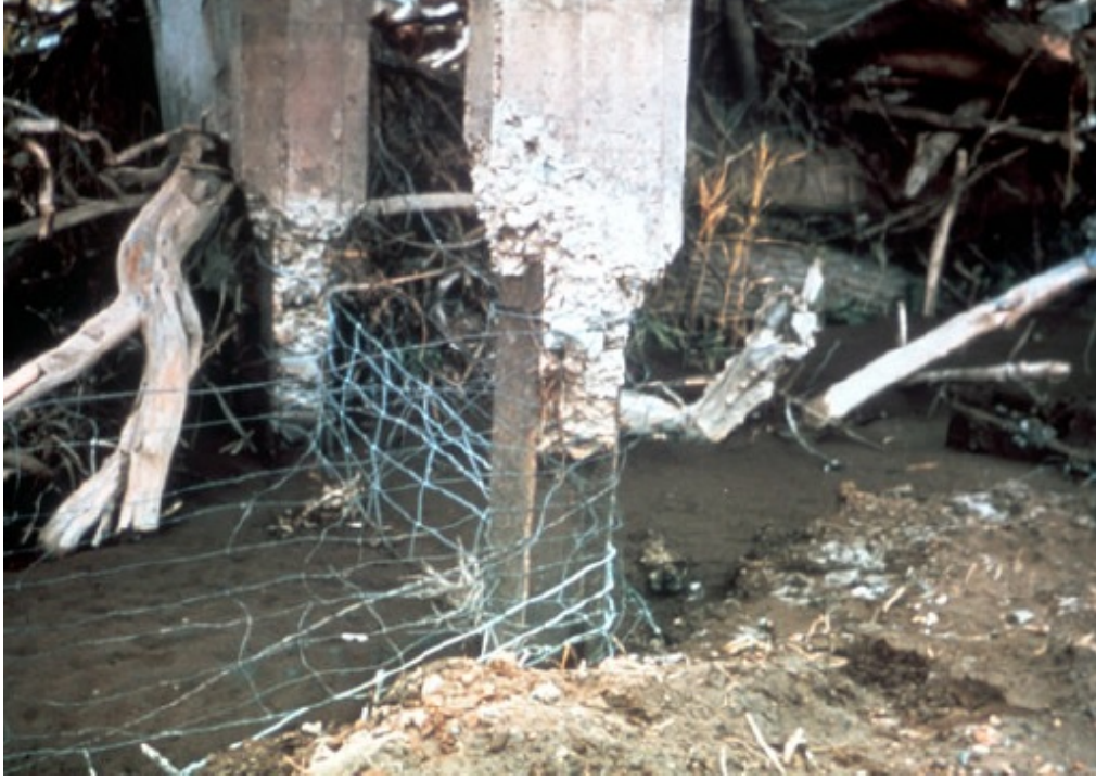
Şekil 1.35. Sülfatın betona etkisinin görüldüğü bir örnek
